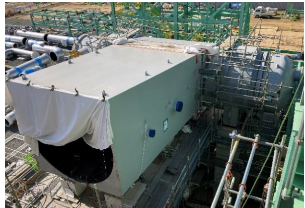
一次据付済みの「復水器」
