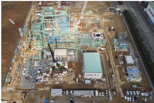
発電所全景（南側から北側を望む）
