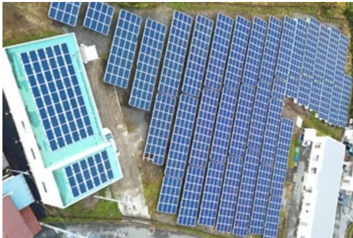
高崎倉賀野発電所 (最大発電出力407kW)
