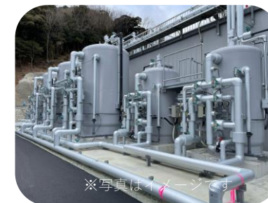
2026年4月以降 稼働予定 新規水処理施設
