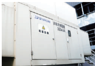
350Kvaの非常用発電機
