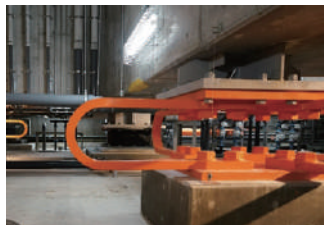
東京本社 免震装置
