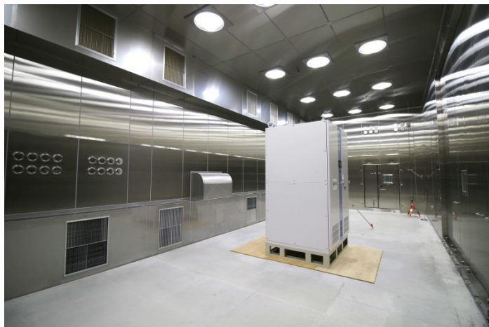
大型恒温恒湿室
