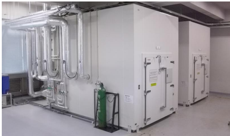
乾燥地植物気候変動応答実験設備
