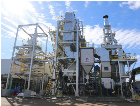
（錦町2MW木質バイオマス発電所）
