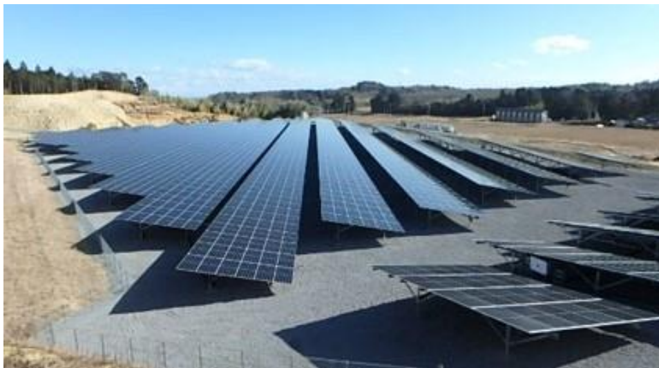
（太陽光発電システム）
