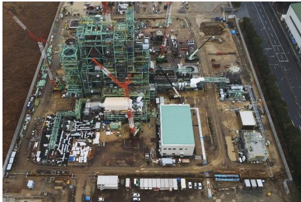
発電所全景（南側から北側を望む）
