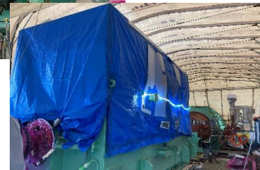
（発電機と中低圧タービン）
