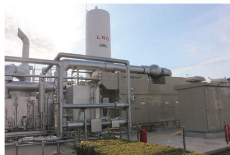
(株)井関松山製造所コージェネレーションシステム
