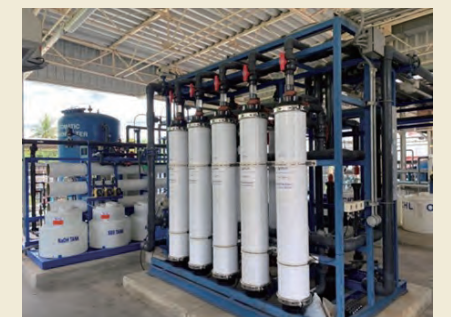
逆浸透膜ろ過浄水システム
