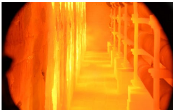
アンモニア燃焼時のナフサ分解炉内の様子
