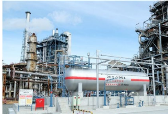
2月に完成したアンモニアの中間供給設備
