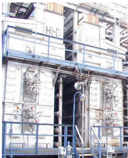
実証実験を行ったナフサ分解炉
