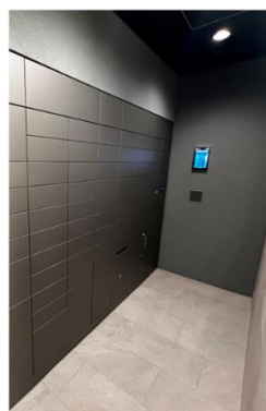
宅配ボックス
