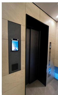
エレベーター
