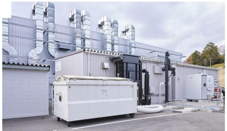
(バイオマス発電施設の外観)
