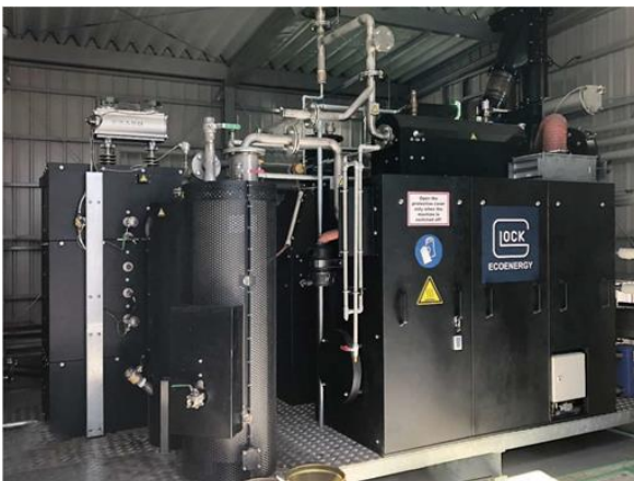
(GLOCK 社製の木質バイオマスガス化熱電併給設備)
