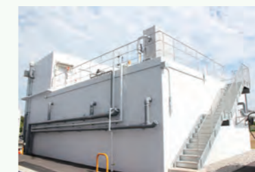
排水処理施設
