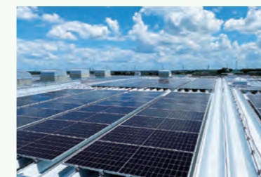
屋根上の太陽光パネル
