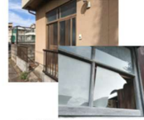
窓・門扉破損で容易に侵入可能
