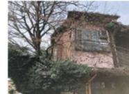
立ち木が建物を覆うほど繁茂
