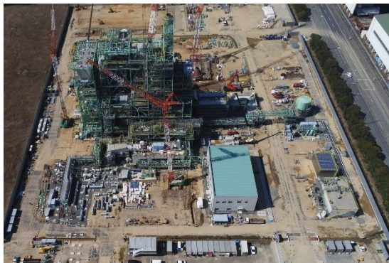
発電所全景（南側から北側を望む）
