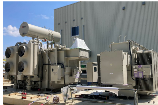
主変圧器及び所内変圧器
