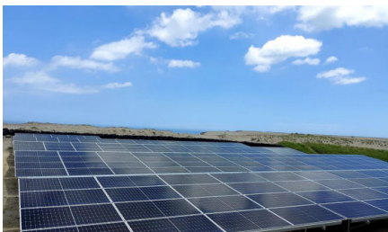
(Kamisu Solar Power Plant)
