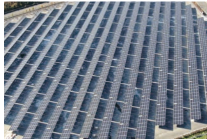
滋賀高月事業場 太陽光発電設備
